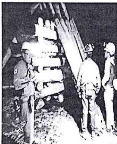
Foto:3- verificación pozo 4 - inactivo, con fuga de agua
